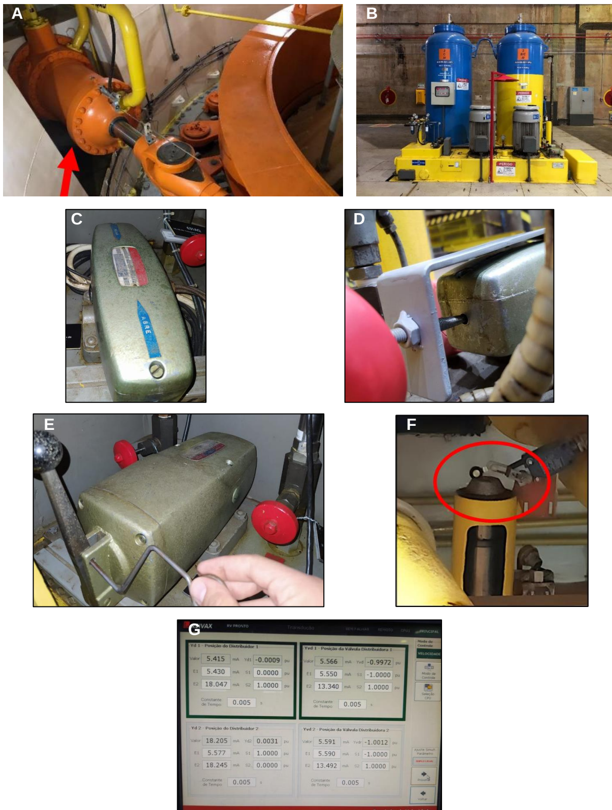
Figura 3. Componentes do regulador de velocidade hidráulico. A. Servomotor e mecanismo distribuidor. B. Sistema hidráulico do regulador de velocidade. C. Eletroválvula de isolamento (S20Q). D. Eletroválvula de isolamento com dispositivo de bloqueio aplicado. E. Eletroválvula trava servomotor (S65). F. Trava do servomotor desaplicada. G. Transdução de UG parada.
