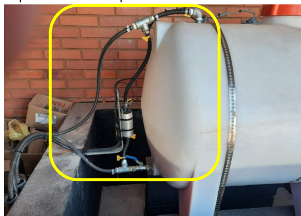
Figura 11. Tanque do GAE com o sistema automático de circulação de diesel instalado. O destaque em amarelo apresenta o sistema instalado.
