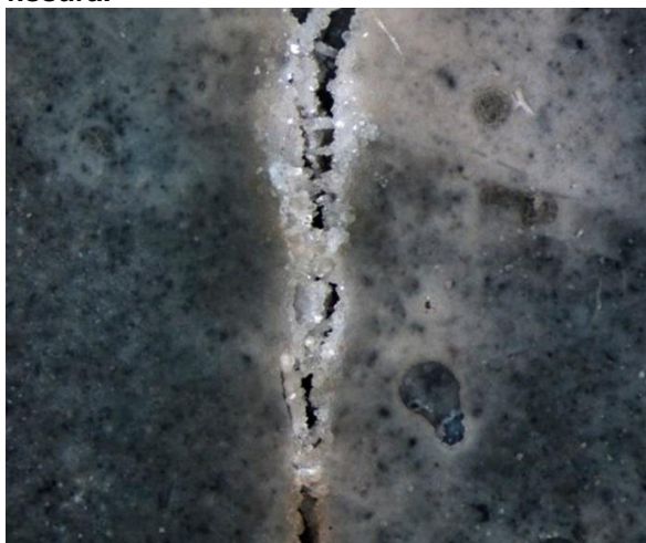
Figura 4. Bioconcreto e a regeneração de uma fissura.
