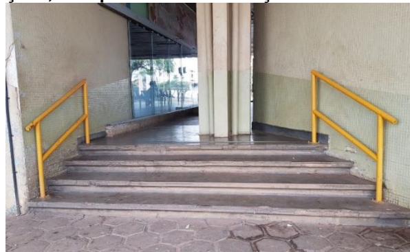
Figura 6. Acesso a lanchonete com obstruções, sem piso tátil e sinalização tátil.
