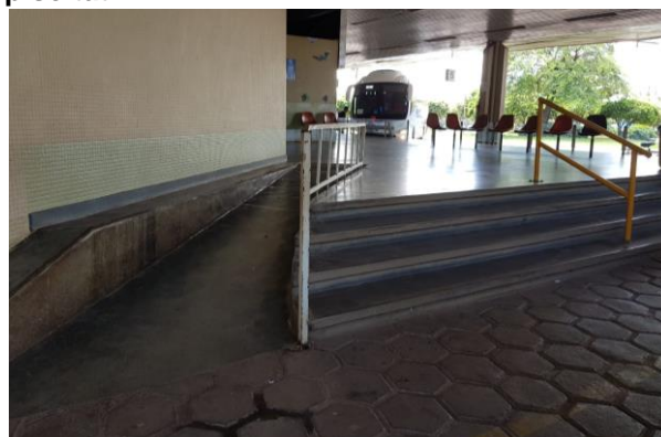
Figura 4. Escada de acesso à área do taxi sem piso tátil.
