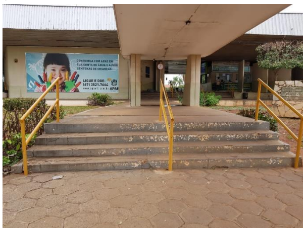
Figura 5. Escada principal sem sinalização tátil.
