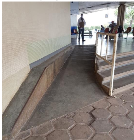
Figura 3. Rampa em desconformidade com a NBR 9050 (2015).
