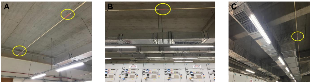
Figura 5. Sistema VESDA dentro de sala elétrica. Os círculos em amarelo evidenciam os locais dos orifícios de aspersão.
