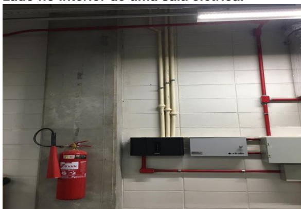
Figura 4. Receptor do sistema VESDA localizado no interior de uma sala elétrica.
