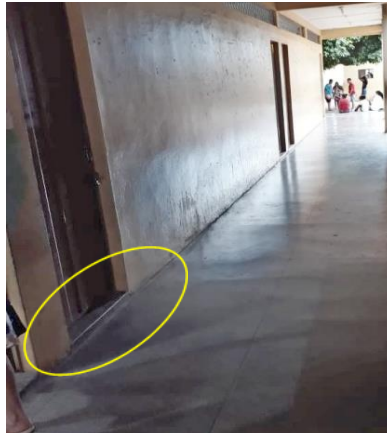
Figura 5. Corredor e desnivelamento do acesso à sala de aula da escola analisada.
