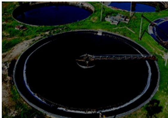
Figura 1. Vista superior da estação de tratamento de lodo ativado. Tratamento primário: remoção de partículas sólidas do efluente.
