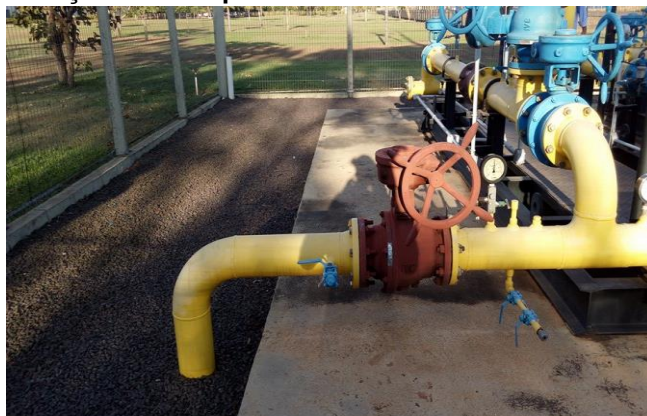
Figura 2. Válvula de Interface (EMRP) Estação medição rede de pressão.
