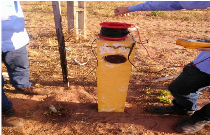
Figura 5. Ponto de teste de um duto enterrado.
