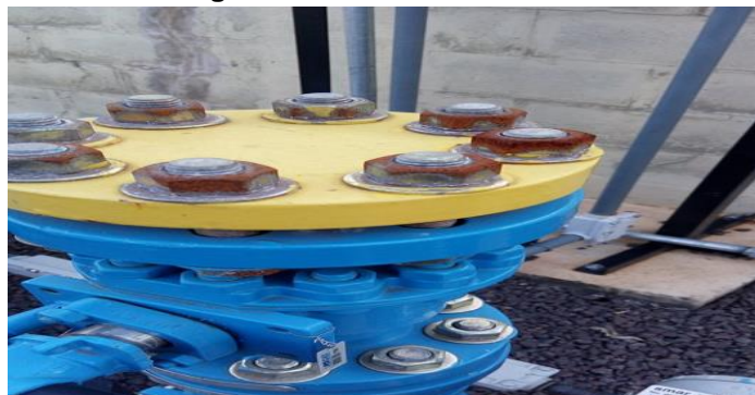
Figura 1. Parafuso de uma válvula de proteção secundária de gás natural.
