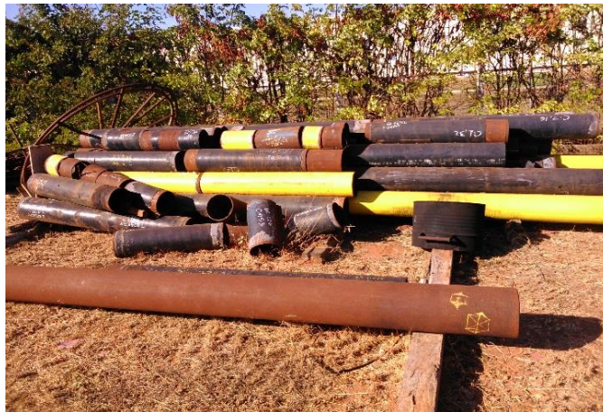
Figura 6. Detalhe da corrosão de tubulações enterradas por um período de 10 anos sem sistema de proteção catódica.
