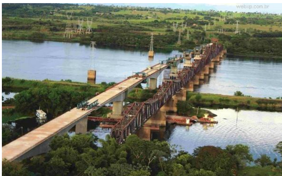
Figura 2: A antiga ponte ferroviária ao lado da “nova ponte” em construção localizada no bairro Jupιά – Três Lagoas, MS.
