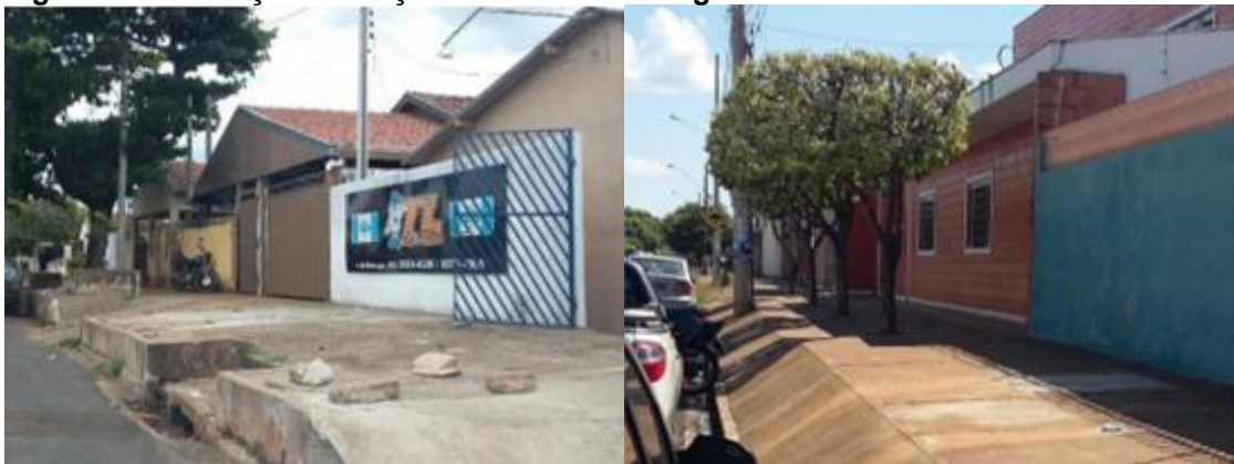
Figura 3. Construção de calçadas com níveis irregulares.
