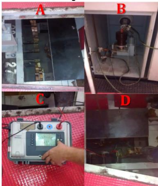
Figura 5. A. Fases do centro estrela desconectadas. B. Aterramento das fases. C. técnico programando o instrumento Megger MIT 520. D. ponteiros do Megger MIT 520 ligadas nas fases na saída do gerador.
