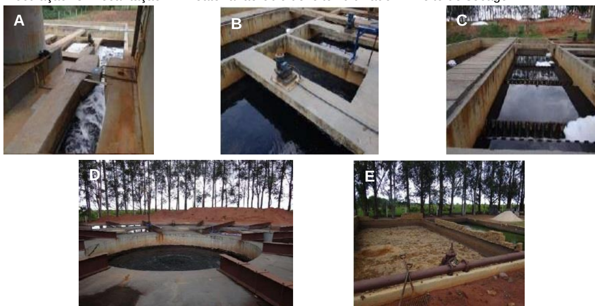
Figura 4. Pós tratamentos físico-químicos e equipamentos para tais. A. Coagulação. B. Floculação. C. Decantação. D. Reator anaeróbio de leito fluidizado. E. Leito de secagem.
