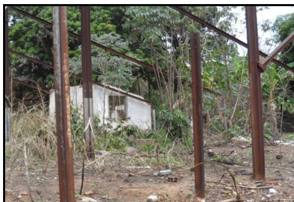
Figura 8: Edificação deteriorada Fonte: Vanessa Barroso, out, 2013.
