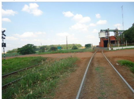
Figura 3: Lastro colmatado por carreamento de material indesejável em passagem em nível
