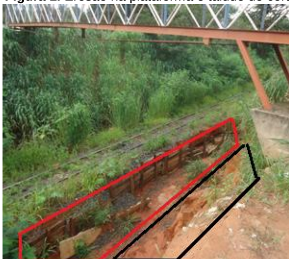
Figura 1. Erosão na plataforma e talude de corte.
