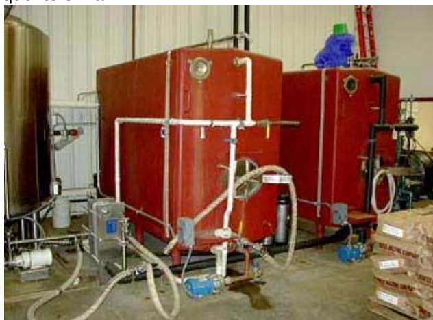
Figura 3. Tanques de armazenamento de água quente e fria.
