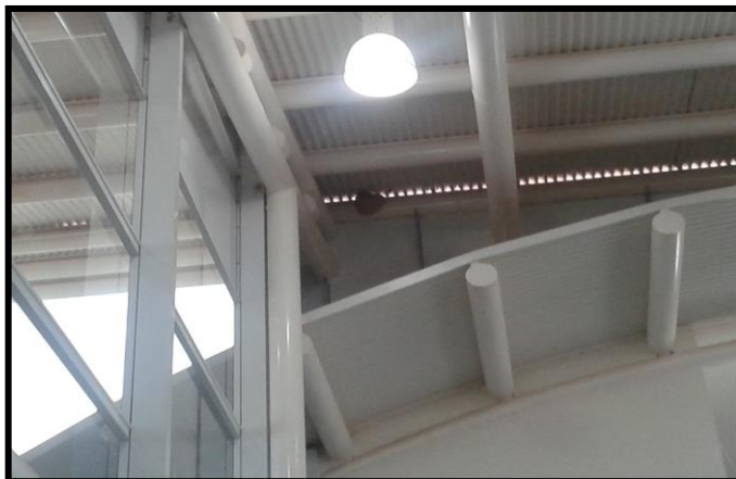
Figura 5: Caixa de marimbondo no telhado. Fonte: Isadora Machado Piacentini, set., 2014.
